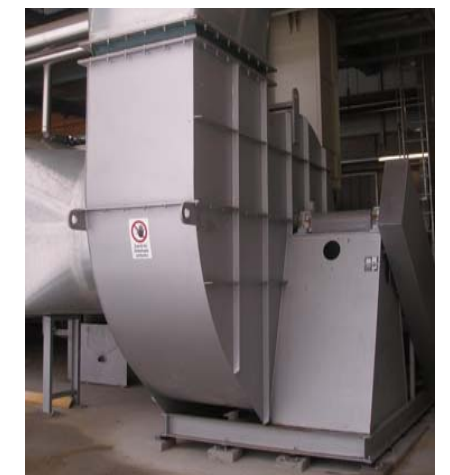
Exhaust air fan
